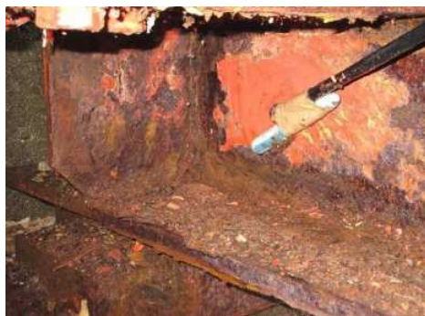
鋼桁の腐食等 （横瀬橋）
