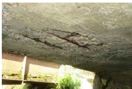
コンクリート床版の剥離・鉄筋露出等 （稻荷2号橋）
